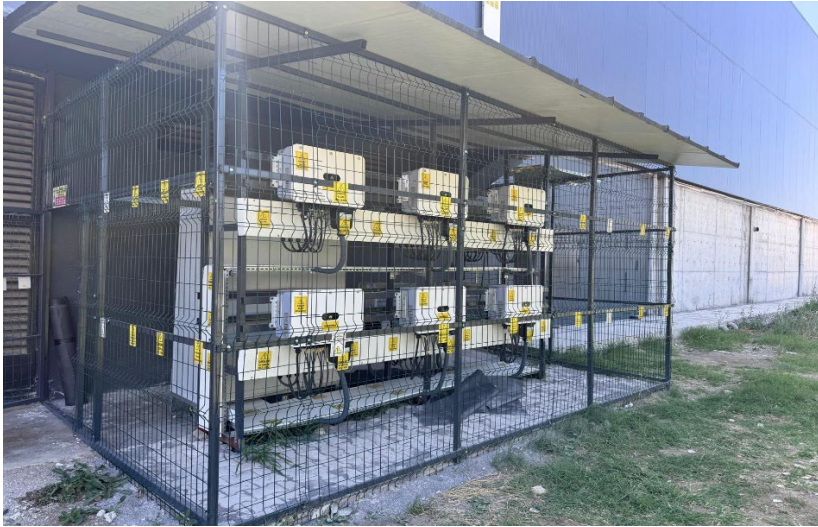
Şekil 3. İnvörtör ve Pano Odası
