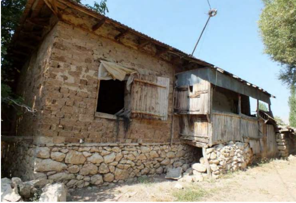
Fotoğraf 2.70. Kuzey Yarıısı Ahır ve Samanlık, Güney Yarıısı İse Ev Olarak İnşa Edilmiş Eski Tip Bir Mesken (Hacıyusuflar)
