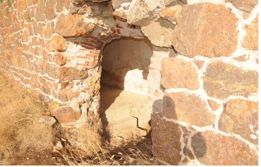
Fotoğraf 4. Aziziye II Tabyası Ön Cephe Duvarı (O. ÜLKÜ)
