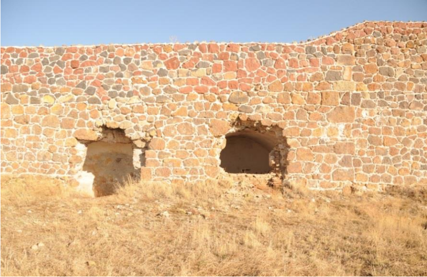
Fotoğraf 3. Aziziye II Tabyası Ön Cephe Duvarı (O. ÜLKÜ)
