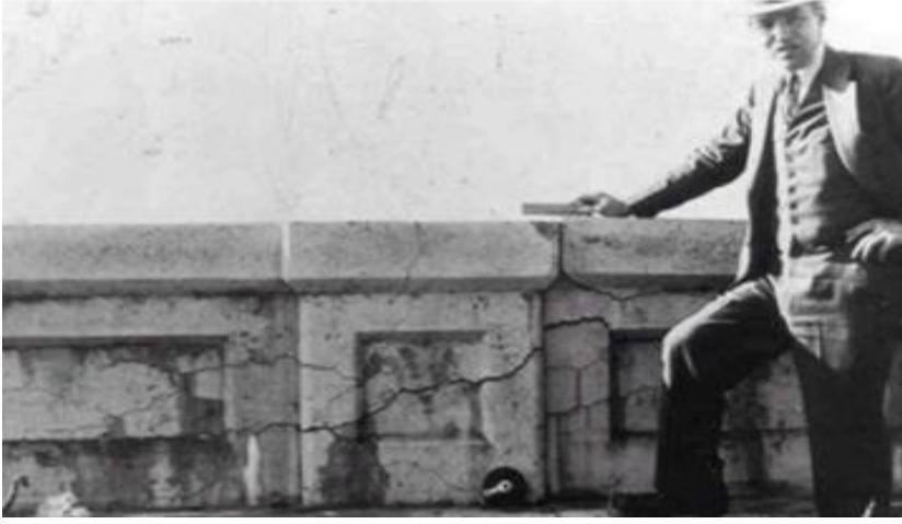
Şekil 1: Stanton ile ASR'ye maruz beton çatlakları (1940).
