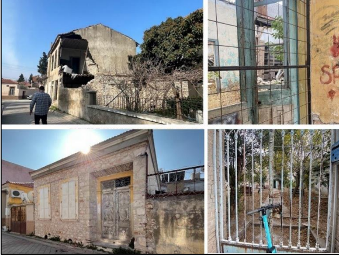
Şekil 8: Ağır hasarlı, metruk yapılardan bazıları
