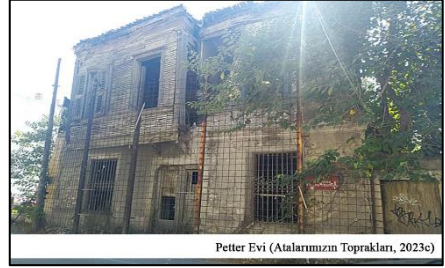
1800'lü yılların ortasında inşa edildi. Ağır hasarlı durumda.
