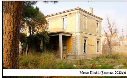
18080'lerde inşa edildi. Ağır hasarlı durumda.
