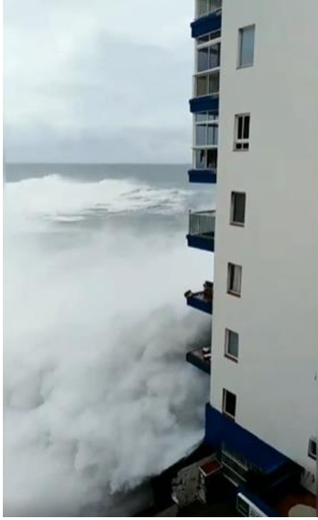
Şekil 26. Deniz Dalgalarının Bir Binada Balkonlarda Oluşturduğu Yıkım (Enormous Waves Wipe Away Balconies in Tenerife, 2018).
