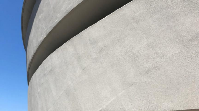
Şekil 195. Guggenheim Müzesi Cephesinde Kontrplak Kalıp İzleri (Mendelsohn, 2023).
