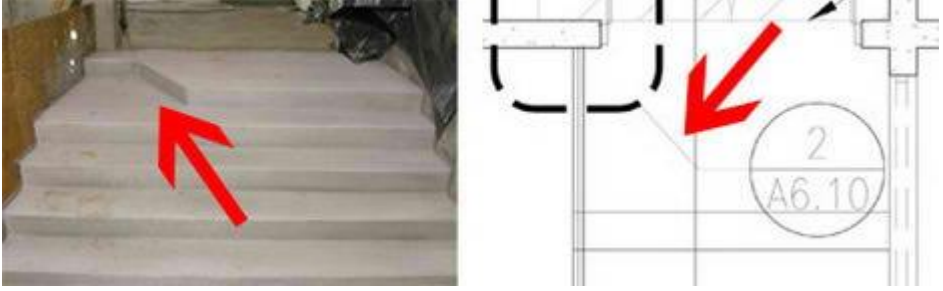
Şekil 17. Teknik Çizimde Çizgi Kalınlıklarına Dikkat Edilmemesi Sonucu Projenin Yanlış Okunmasına Yol Açan Uygulama Hatasına Bir Örnek (Building Construction Mistakes, 2022).
