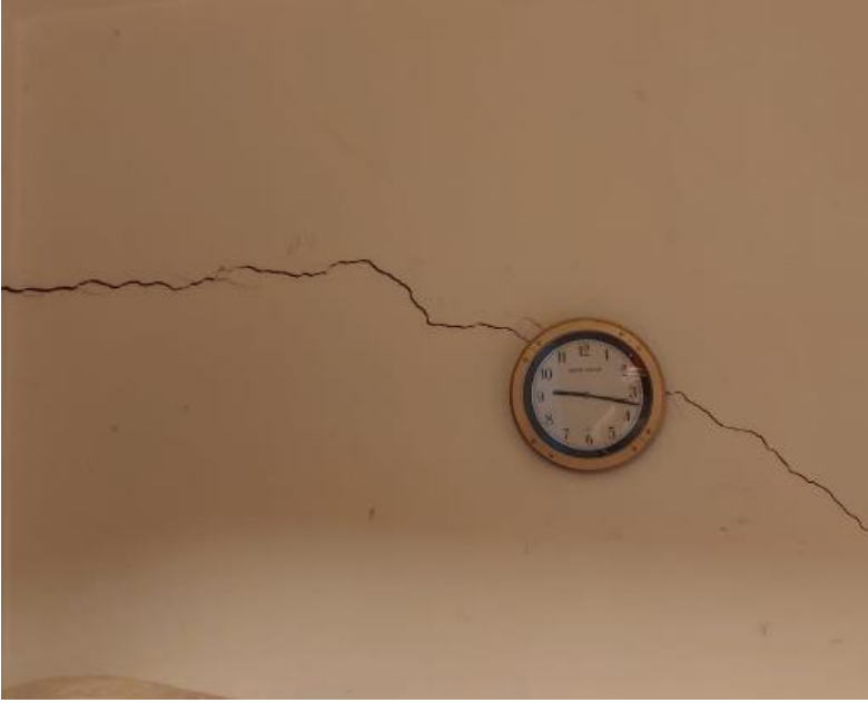
Şekil 24. Bir Bölücü Duvar Üzerinde Yapının Oturmasından Kaynaklı Oluşan Derin Çatlaklar (Demirarslan, 2023)
