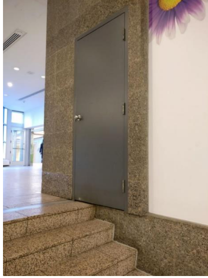
Şekil 20. Mimari Teknik Çizimde Yapılan Dikkatsizliklerin Hatalı Uygulama Sonuçlarına Bir Örnek (78 Architects Who Had One Job And Still Failed, 2016).
