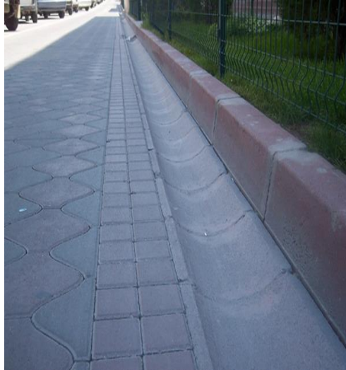
Şekil 13. Klasik Dönem Osmanlı Mimarisinde Detayları Düşünülmüş, Zeminde Bir Su Kanalı (Topkapı Sarayı) ile Günümüzde Yeterli Şekilde Detay Düşünülmeyen Standart Olarak Üretilerek Yapılan Bir Su Kanalı Görülmektedir (Demirarslan, 2014).
