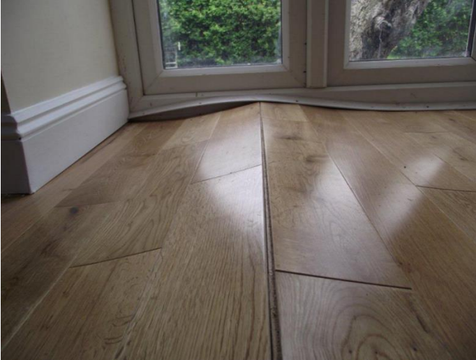
Şekil 45. Rutubet ve Su Etkisi Altında Kalan Bir Ahşap Parkenin Gösterdiği Aşırı Çalışma ve Deformasyon (Minimizing Moisture from Subflooring, 2017).
