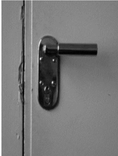
Şekil 21. Detaylı Bir Şekilde Düşünülmeyen Bir Kapı Kanadı- Kasa İlişkisinde Kullanım Sırasında Ortaya Çıkan Hasar.
