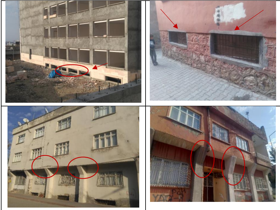
Şekil 6. Siirt ilinde gözlenen kısa kolon örnekleri
