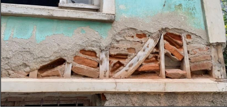
Fotoğraf 99: Restore Edilmemiş Ereğli Evlerinden Birinin Bina İskeleti Örneği
