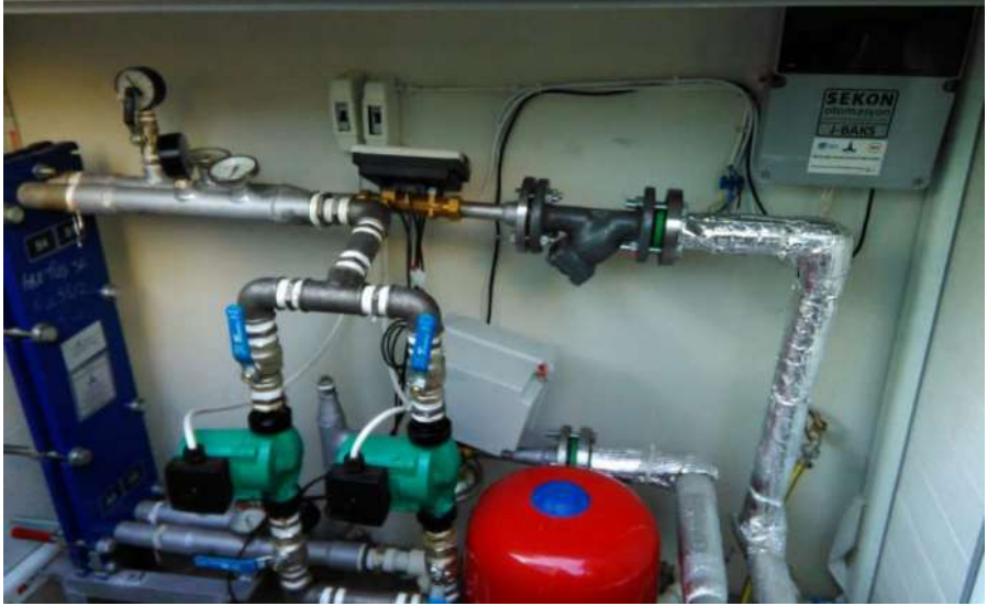
Şekil 7: Bina Altı Eşanjör Örneği
