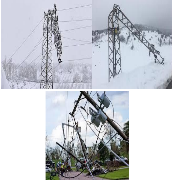
Şekil 3 Zarar görmüş güç sistemi iletim altyapısı
