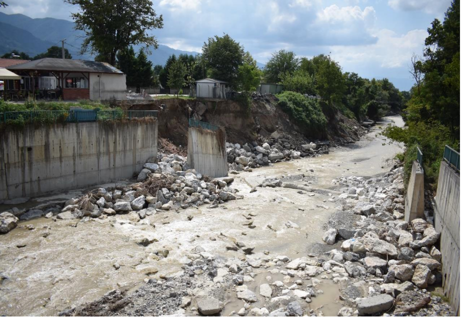
Fotoğraf 3. Uğursuyu Deresi'nin Taşkın Sonucu Verdiği Tahribat.
