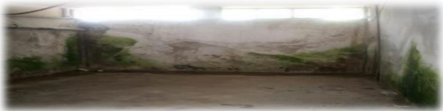
Şekil 5. Zemin suyunun bodrum duvarlarında neden olduğu hasarlar (Üstündağ, 2016)
