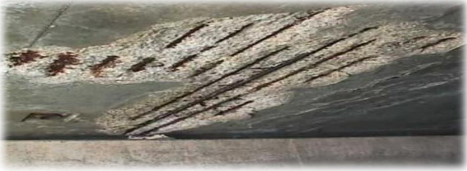
Şekil 2. Donatılarda korozyon etkisi (Şahinoğlu, 2017)
