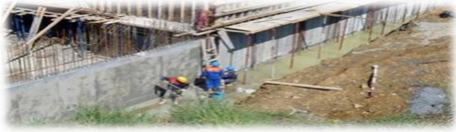
Şekil 12. Yan yüzeylerinde su bulunan temel örneği (Uygunoğlu, 2012)
