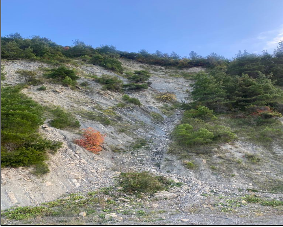
Fotoğraf 5: Bozkurt İlçesinin Yol Kenarında Flişli Alanlarda Meydana Gelen Heyelan.
