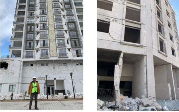
Şekil 12. Zemin büyütmesine bağlı gelişen yapı hasarları
