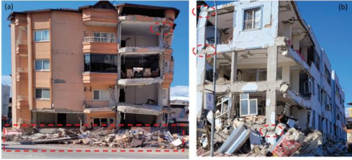
Şekil 16.(a), (b). Hatay Kırıkthanda yumuşak kat hasarı ve toptan göçmeye maruz kalan binalar (Yenidoğan, 2024)
