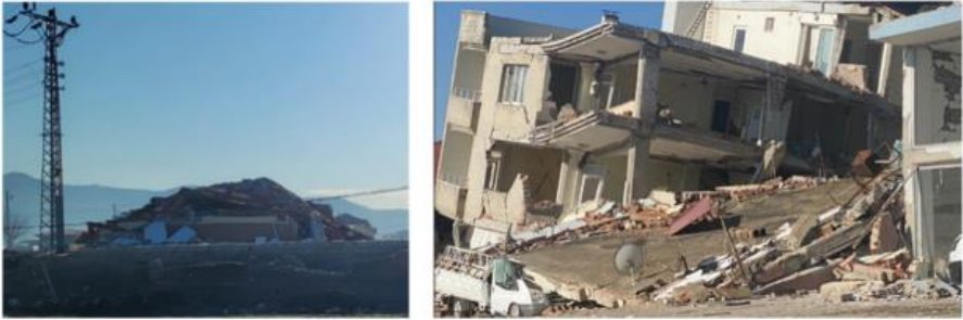
Şekil 14. Kırsal kesimde az katlı yapılarda gözlemlenen toptan göçme ve ilçe merkezinde sıklıkla rastlanan ağır hasarlı binalar (Yenidoğan, 2024)
