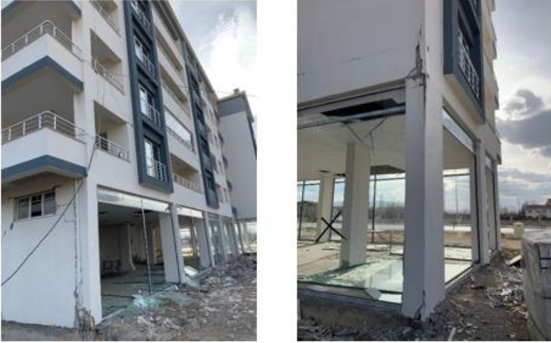
Şekil 13. Deprem yüklemesine etkisinde taban kesme kuvvetine bağlı gelişen hasarlar
