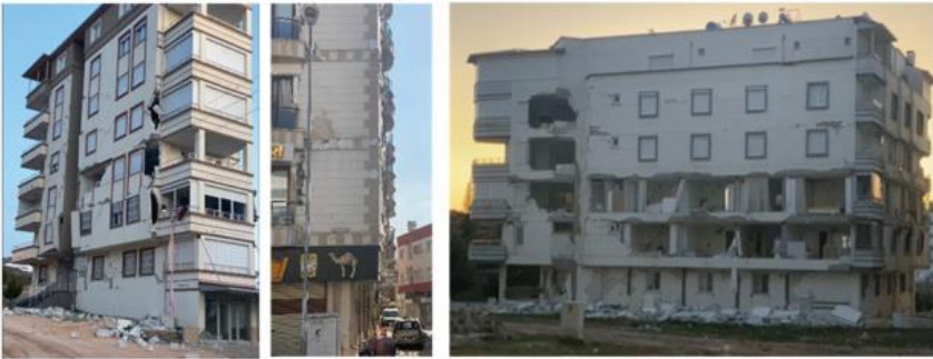
Şekil 15. Dolgu duvarların düzlem dışı davranışına bağlı yapısal olmayan hasarlar (Yenidoğan, 2024)
