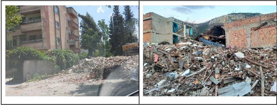
Şekil 3. 6 Şubat 2023 Kahramanmaraş Depremleri; Kahramanmaraş (solda, 09.07.2023) ve Hatay (sağda, 20.03.2023) illerinden görünüm (Ali Rahmi KAYA arşivinden)
