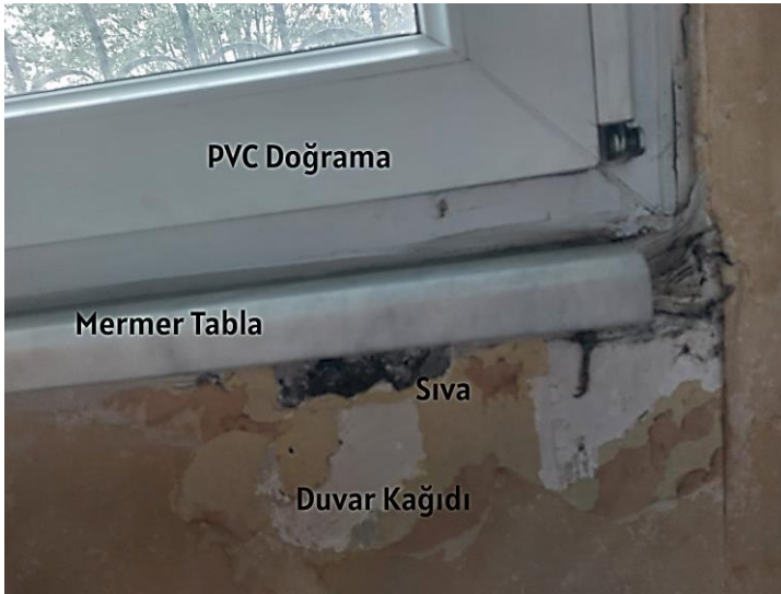
Görsel 300. Duvar Kaplamasından Sonra Takılan Pencere Doğramasının Neden Olduğu Hasar.
