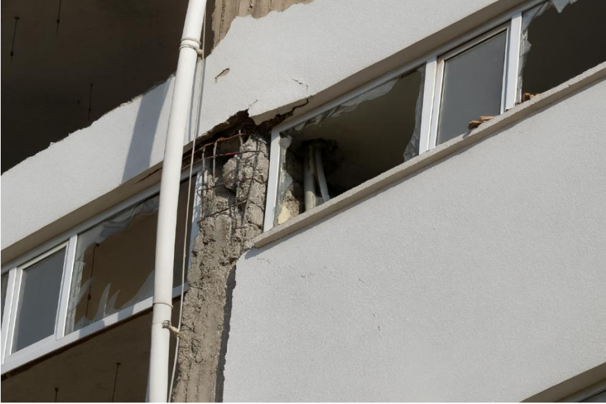
Görsel 35. Bant Pencere ve Depremde Kısa Kolon Hasarı (İlki, Orakçal vd., 2012).
