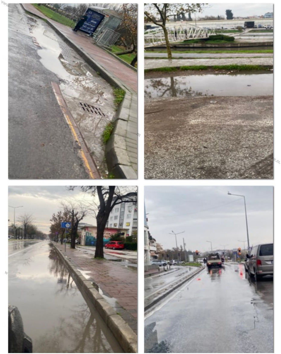
Şekil 23. Sarıçay ve çevresi drenaj problemleri (Orijinal, 2025)
