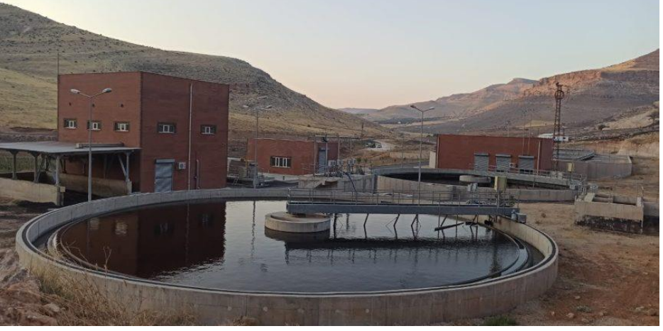
Fotoğraf 2. “Yeşilli Atıksu Arıtma Tesisi” tanıtım fotoğrafı, 2025
