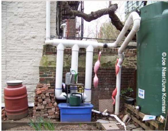
Şekil 5. New York belediyesi tarafından bir topluluk bahçesine kurulan yağmur suyu toplama sistemi.
