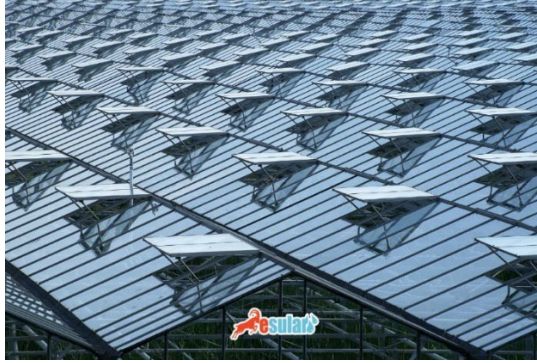
Şekil 3 Cam örtülü blok seraların çatıdan havalanması (Anonim 3 2025)
