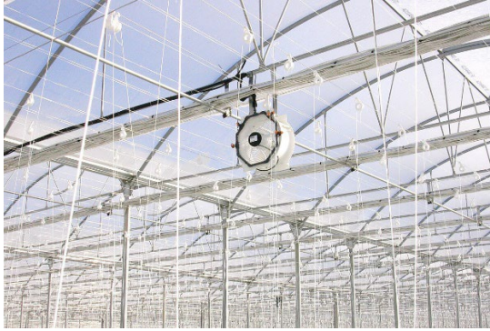
Şekil 7 Çatıya monte edilen fan sistemi (Anonim 7 2025)
