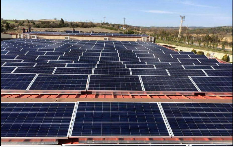
Fotoğraf 11: Özel Bir Şirkete Ait Olan Alışveriş Merkezinin Çatısına Kurulmuş Güneş Enerjisi Panelleri 70 .
