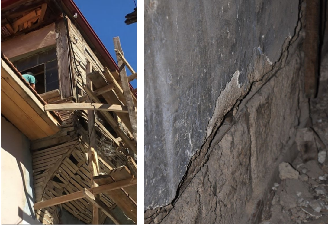
Şekil 4.100: a) Alanda görülen bağdadi dolgulu ahşap karkas sistem, b) Yığma taş duvarın üzerine kaplanmış kireç sıva örneği (Kişisel arşiv, 2019)
