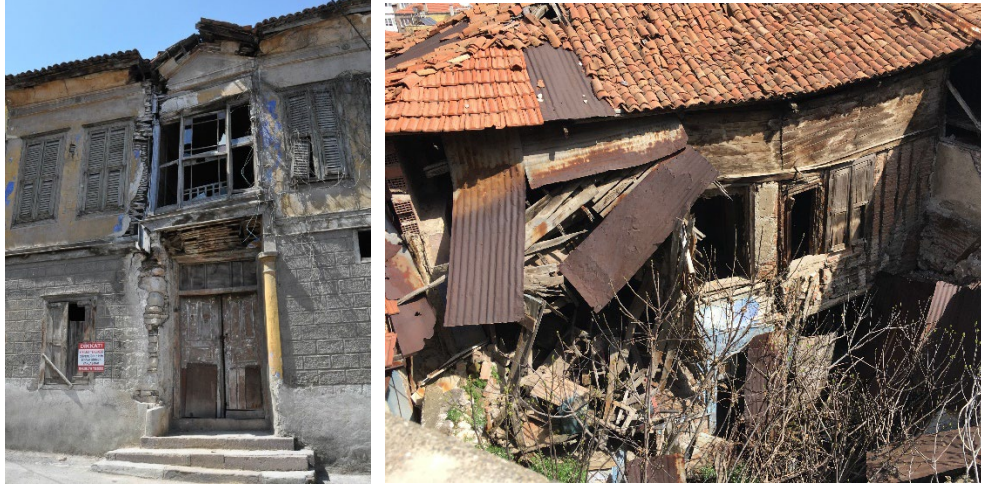
Şekil 3.10: Esaslı onarım yapılması gereken 255 Ada 4 Parseldeki tescilli yapının ön ve arka cephesi (Kişisel arşiv, 2018)
