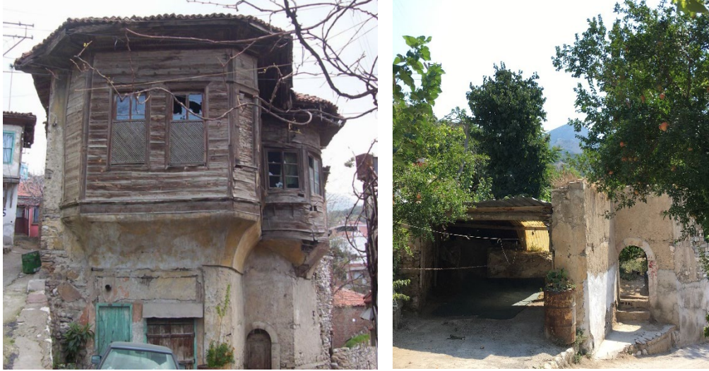
Şekil 5.12: a) Koruma çalışmaları kararının doğru zamanda alınmaması nedeniyle kaybedilen, dokunun en eski yapılarından biri olan 214 Ada 50 parseldeki tescilli yapının yıkılmadan önceki resmi (Soma Belediyesi arşivi), b) Yapının yıkıldıktan sonraki, günümüz hali (Kişisel arşiv, 2017)
