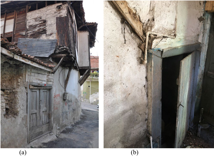
Şekil 4.26: a) Konutun bahçe kapısından yapılan girişi, b) Bahçe kapısının arkasında bulunan tuvalet kapısının resmi (Kişisel arşiv, 2019)
